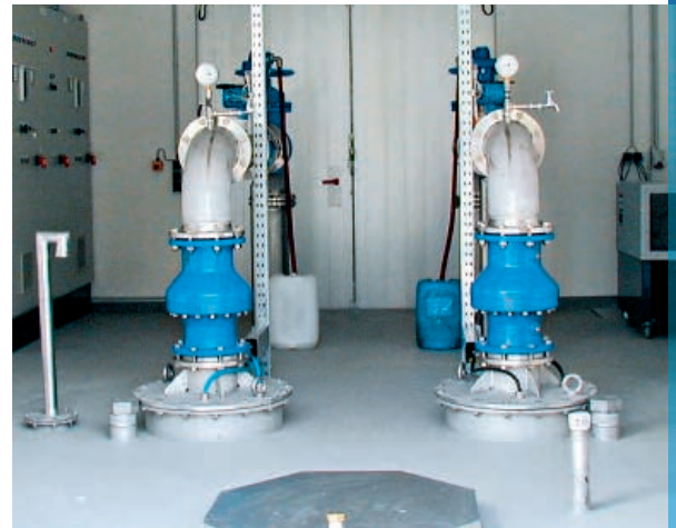
Effiziente Wassergewinnung: Die Pumpanlage der Grundwasserfassung eines Wasserwerks.
